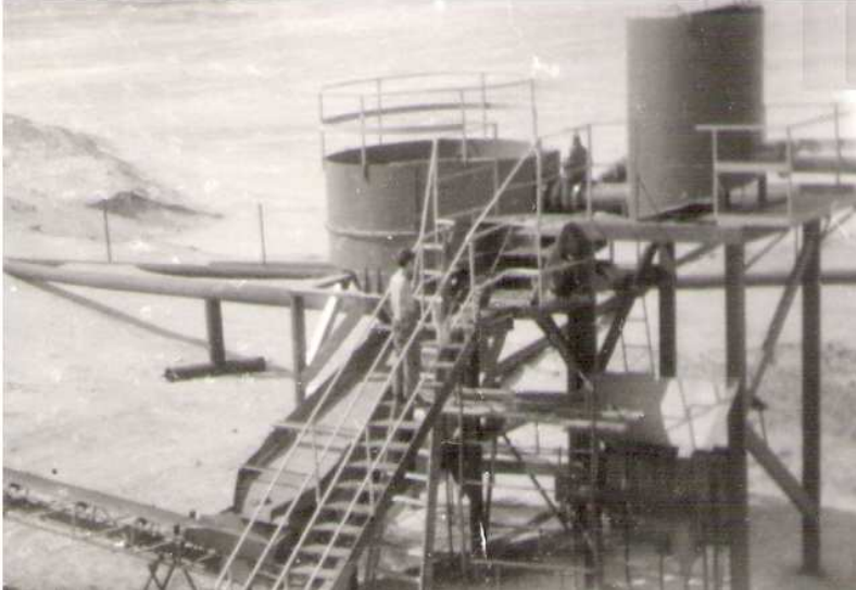
Rys. 1. Widok na instalację odwadniania pulpy wodno-popiołowo-żuźlowej i produkcji kruszywa Elporyt
